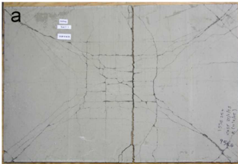
Fallo de tracción de la armadura
